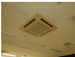
(改修前) 空調用室内機
